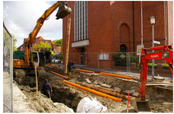
Sanierung „Hof von Holland“, Gründung des Schmutzwassersammlers vor der Kirche St. Michael, 18.5.2010
